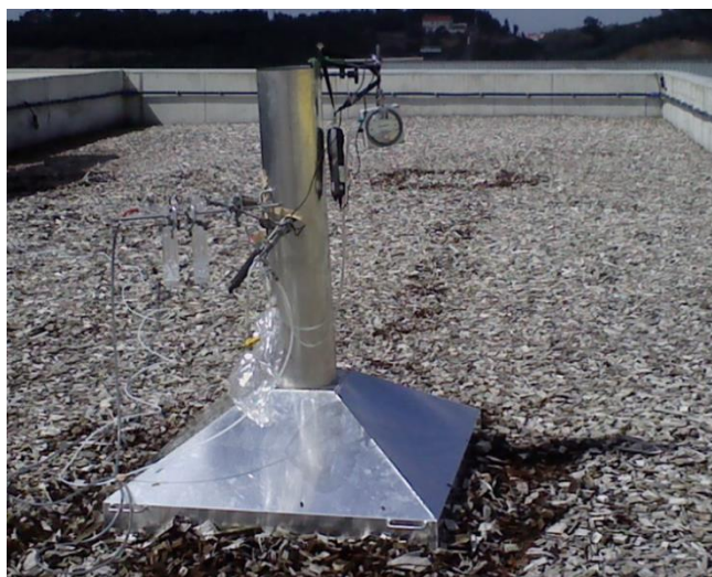
Figura 4.1: Sistema de amostragem no biofiltro.
