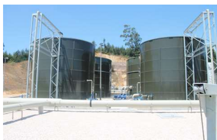
Reactores biológicos da ETAL da Abrunheira.
