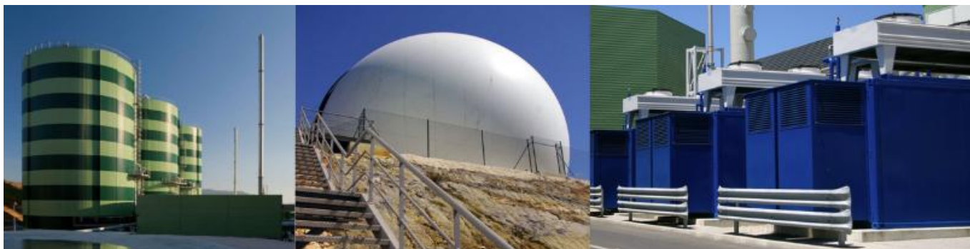
Figura 9 Biodigestores, gasómetro e moto-geradores
